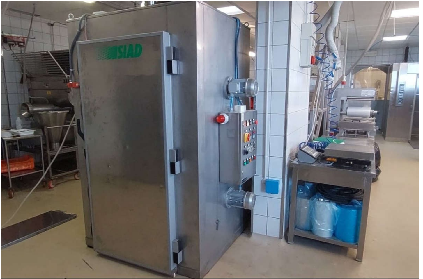
L'impianto di criogenesi Siad dell'azienda Il Matterello
